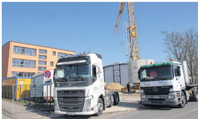
Hoch hinaus: Seit Ende März dreht sich neben der Loitzer Regionalschule der Kran für den Hort-Neubau.
