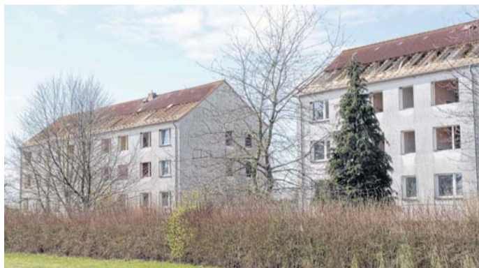
Von Kopf bis Fuß auf Abriss eingestellt: Im Jarmener Ortsteil Neu Plötz hat der Rückbau der zwei 12-WE-Blöcke begonnen.
