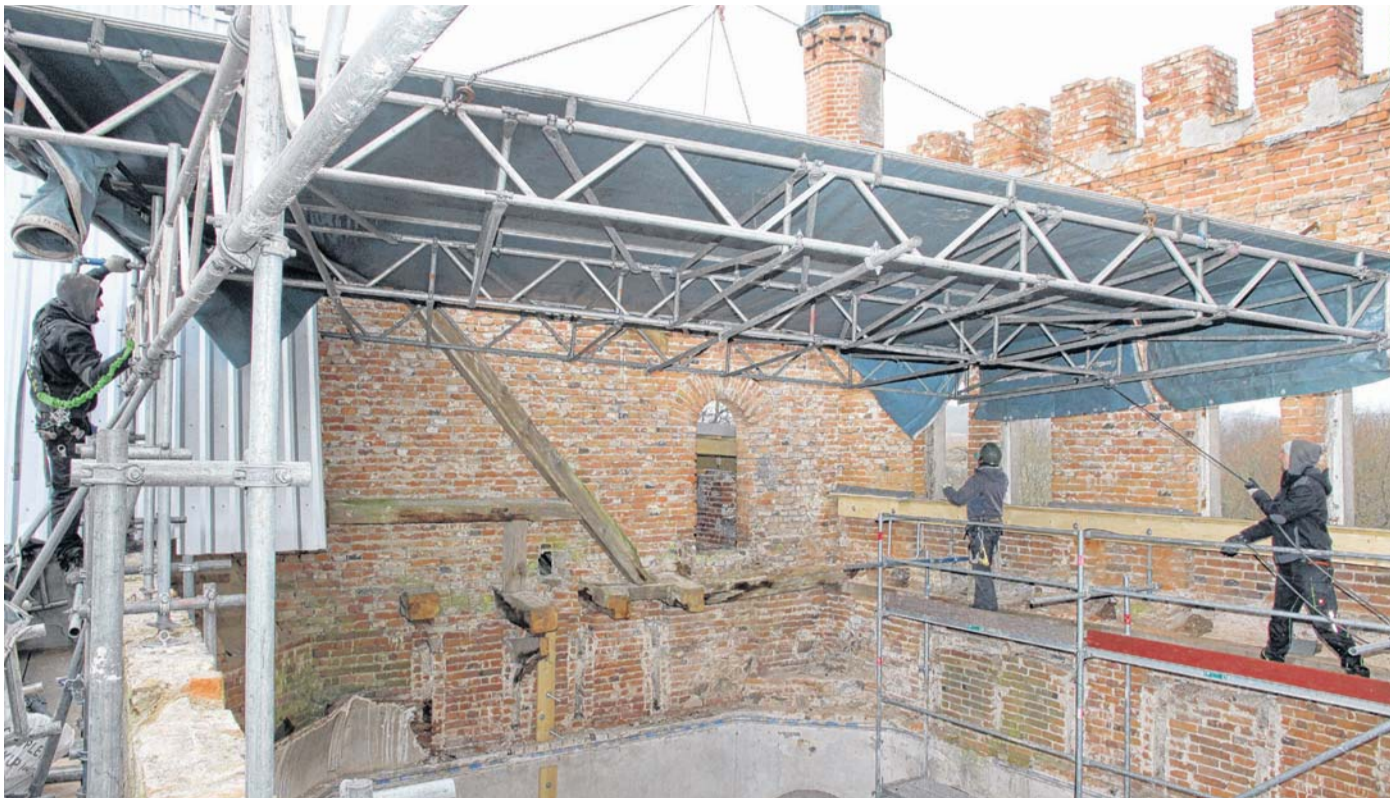
Zu Wochenbeginn kamen die letzten beiden Segmente für das Notdach der Broocker Schloss-Ruine an ihren Platz. Im Mittelrisalit entschieden sich die Planer für eine Leichtbau-Konstruktion, weil es dort nicht mal mehr Reste des alten Dachstuhls gibt. FOTO: STEFAN HOEFT
