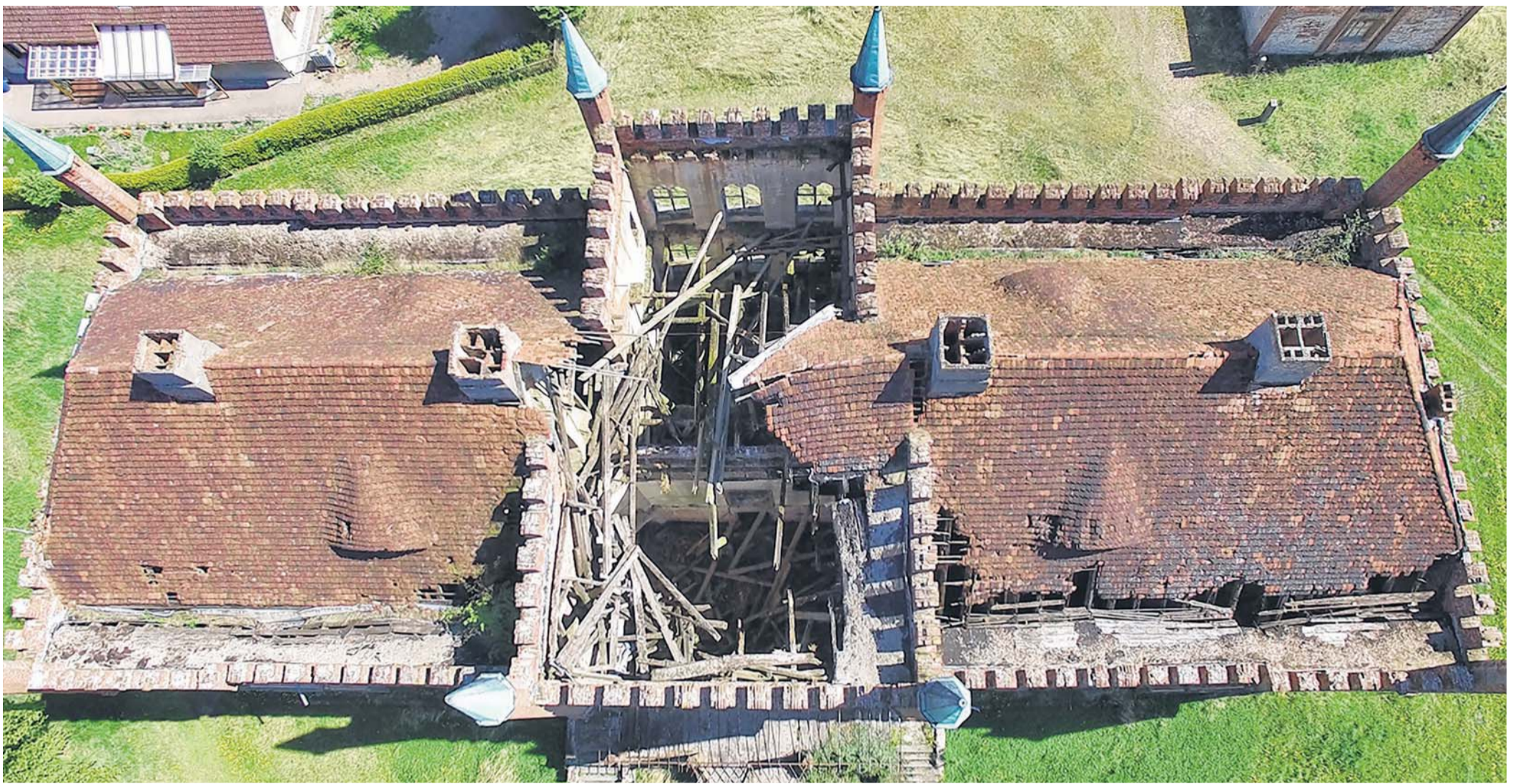
Ein Blick auf das Schlossgebäude von oben zeigt, dass das Dach nicht mehr zu retten ist. Geplant ist, es Schritt für Schritt abzutragen.
