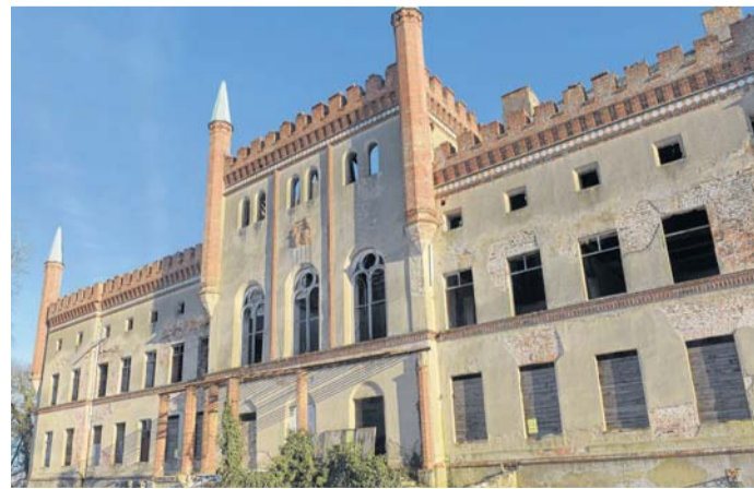
Das Schloss Broock befindet sich in einem baufälligen Zustand. Doch es gibt Hoffnung, dass es gerettet und zu einem Veranstaltungszentrum ausgebaut werden kann. FOTO: NK-ARCHIV
