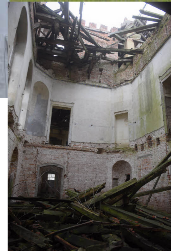
Das Dach und die Decke im Mittelbau sind eingestürzt.
