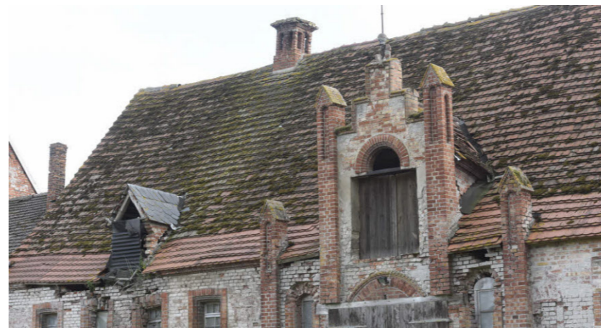
Auch die Nebengebäude des Anwesens sind seit vielen Jahren dem Verfall preisgegeben.
